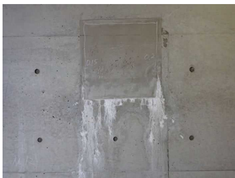
写真-3 側壁（遊離石灰）
