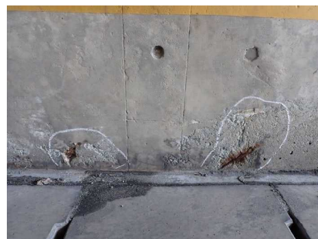
写真-4 側壁（鉄筋露出）
