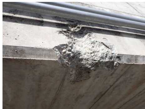
写真-2 頂版（剥離）
