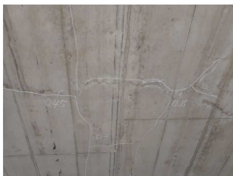
写真-1 頂版（ひびわれ）
