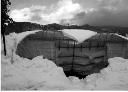
豪雪により倒壊した園芸パイプハウス
