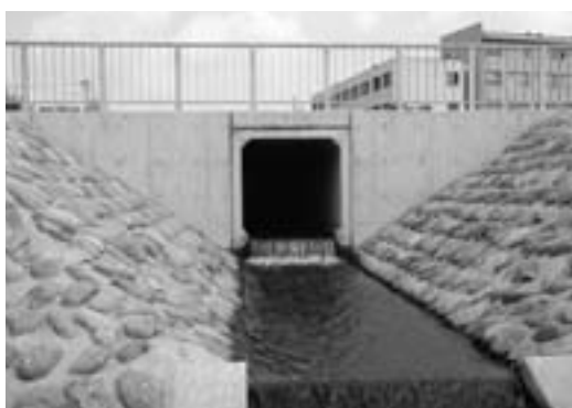
▲山形電波高校の西側に整備した雨水管の樋門
